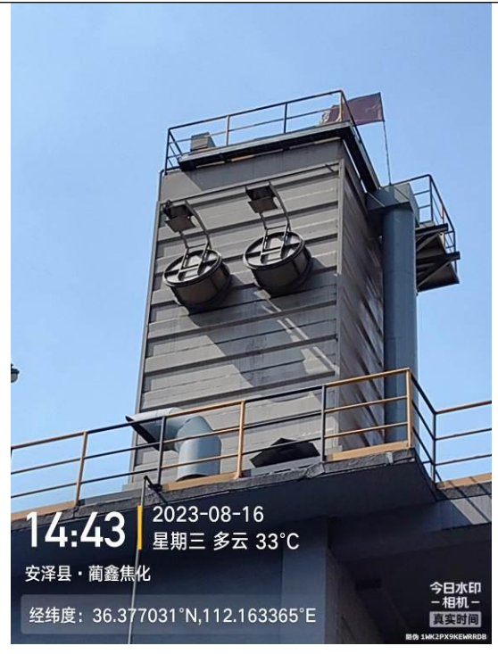
转运站 4#, 除尘器排放口
