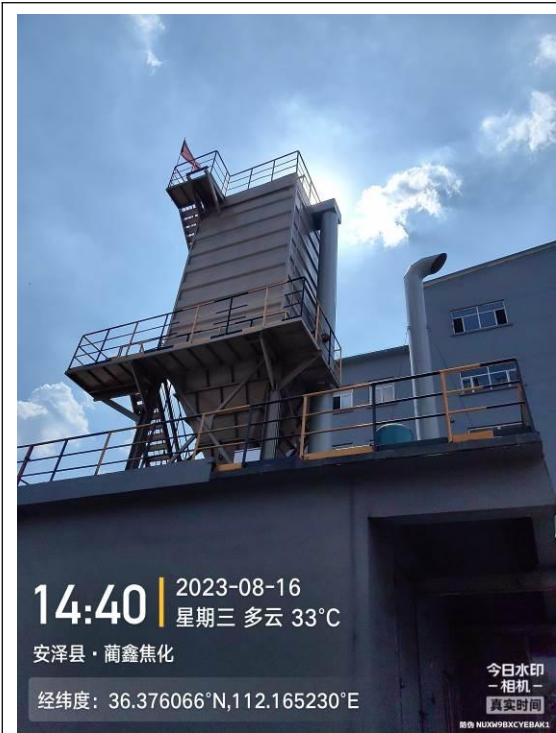
转运站 3#, 除尘器排放口
