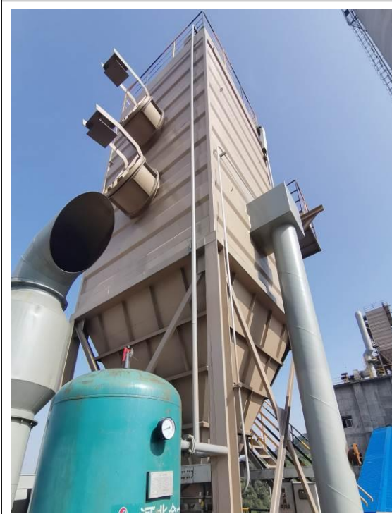
转运站 5#, 除尘器排放口
