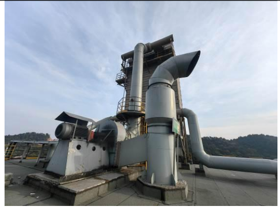
筒仓上部除尘器排放口
