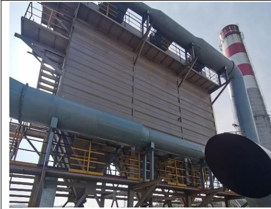
煤塔除尘器排放口
