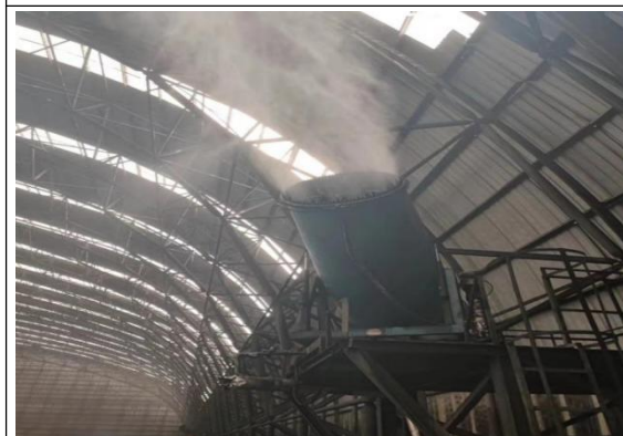
二期焦化煤棚雾炮
