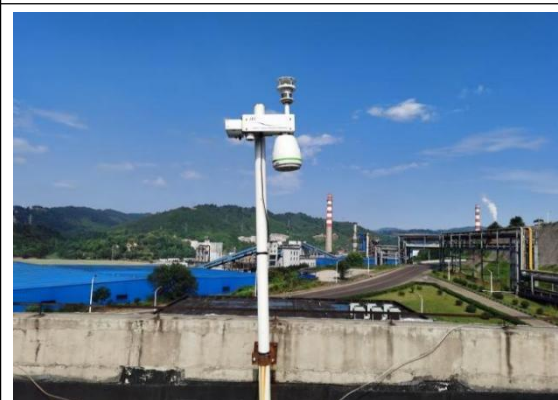
厂区南侧杆式空气质量监测仪 1#
