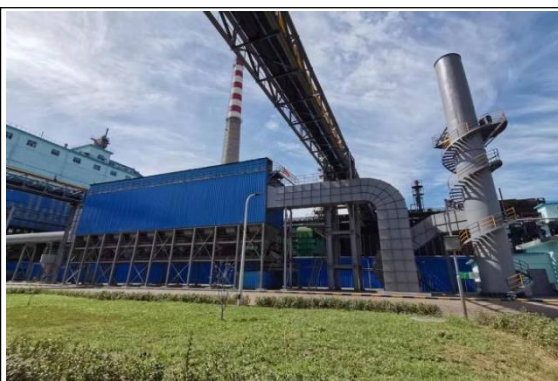
机侧炉头烟地面站
