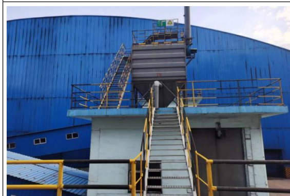
精煤转运除尘器 7#
