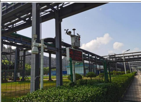
厂区北侧杆式空气质量监测仪
