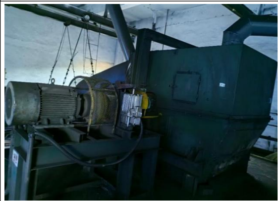
煤 6#皮带落料点
