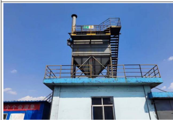
精煤转运除尘器 1#
