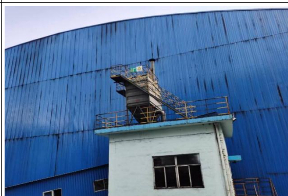
精煤转运除尘器 6#
