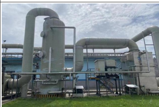
污水站废气处理装置
