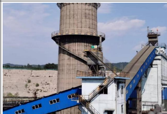
精煤转运除尘器 8#
