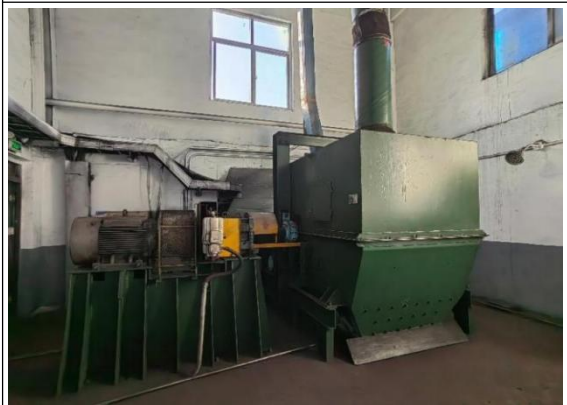
煤 1#皮带落料点
