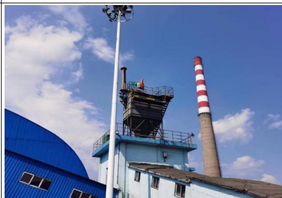
精煤转运除尘器 2#
