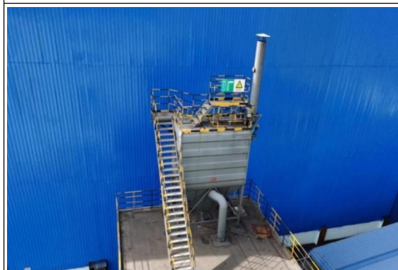
精煤转运除尘器 5#
