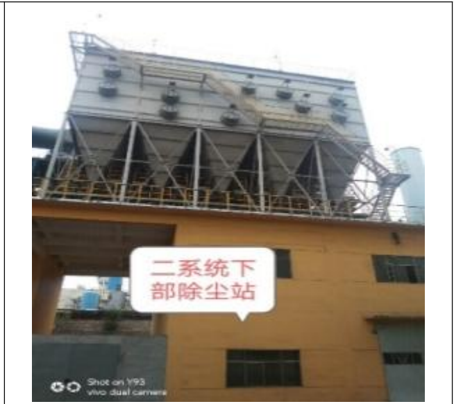
二系焦仓地面除尘站
