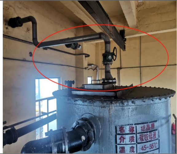
硫铵工段 2#结晶槽VOCs放散点
