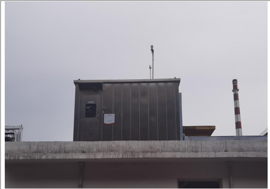
一回收原硫铵操作室顶部非甲烷总烃监测设备
