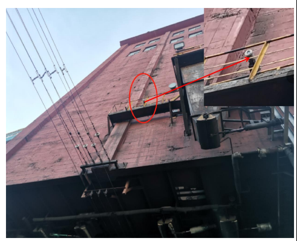
1#焦炉煤塔西视频监控装置
