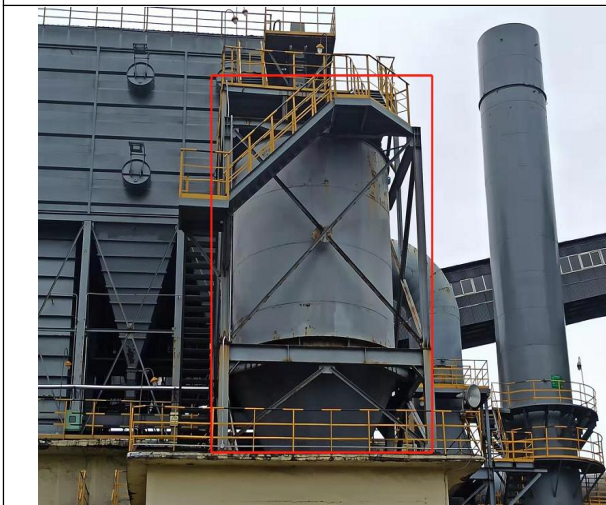
三系统地面上部除尘器除尘灰料仓
