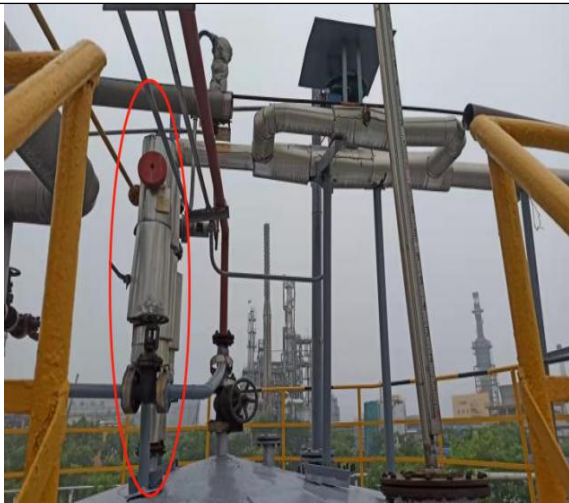
洗油槽VOCs放散点（引煤气负压回收系统）
