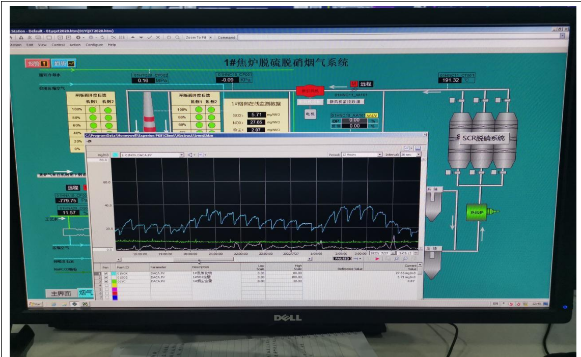
1#焦炉烟气脱硫脱硝 CEMS 数据、生产设施运行参数接入 DCS 系统截图
