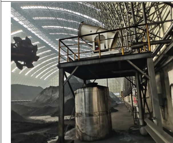
储煤场喷雾除尘器
