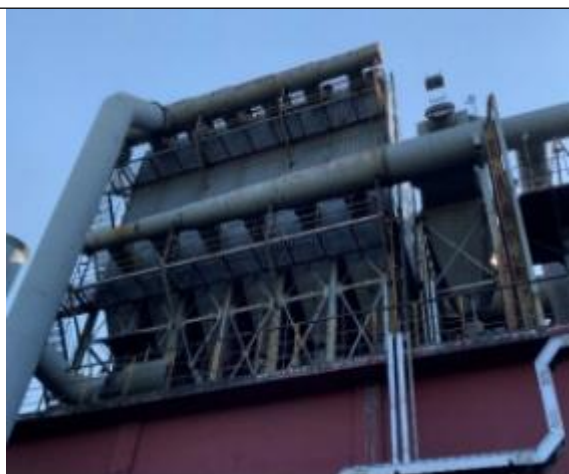
一系装煤推焦地面除尘站
