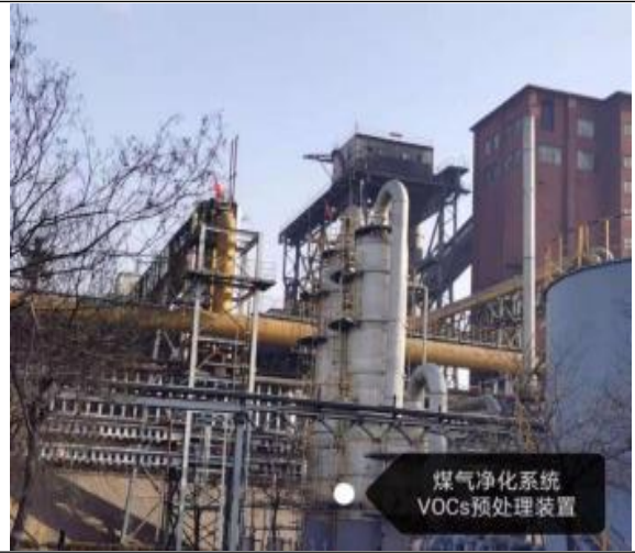
化产粗苯工段含VOCs废气处理设施
