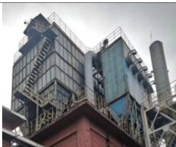
二系装煤推焦地面除尘站
