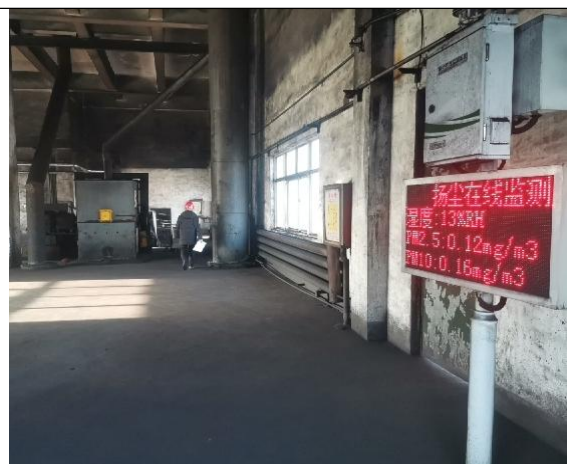
213 输煤皮带机头 TSP 监测仪
