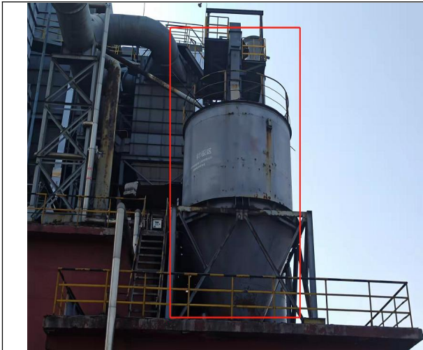
三系干熄焦地面站除尘器除尘灰料仓
