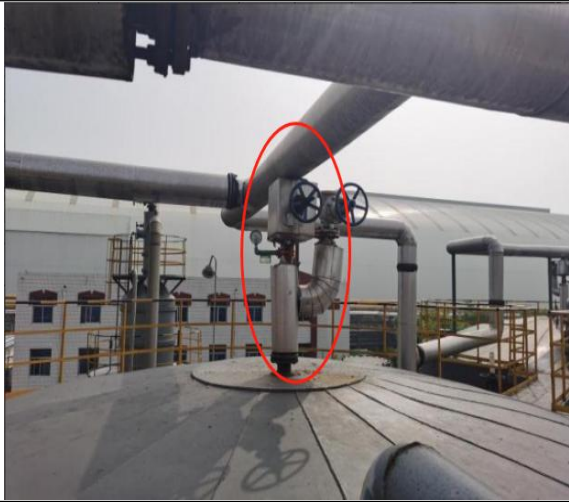
冷鼓工段 2#剩余氨水槽VOCs放散点
