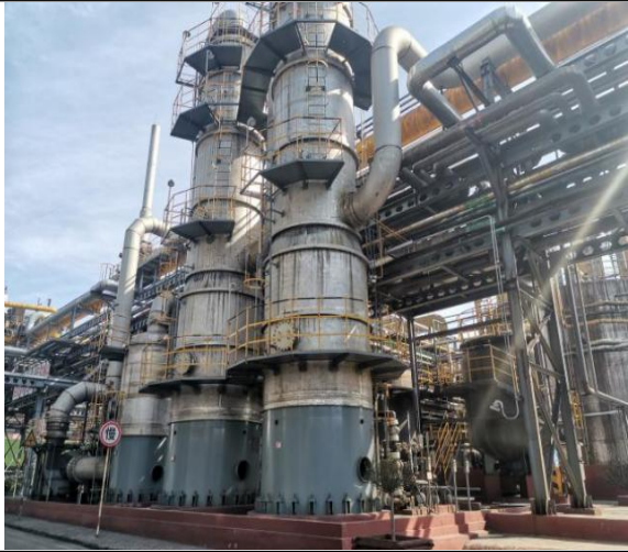
一回收放散点放散气 (VOCs) 处置设施
