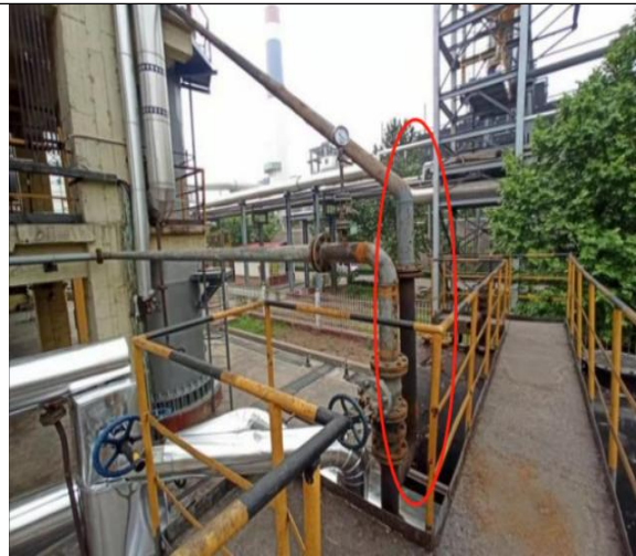
残渣槽VOCs放散点（引焦炉燃烧）
