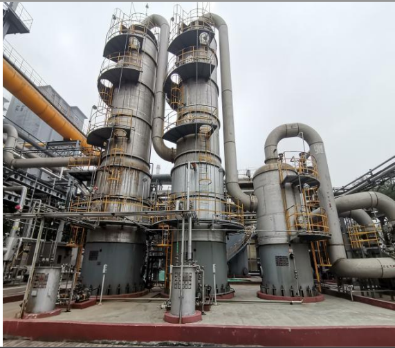
三回收放散点放散气 (VOCs) 处置设施
