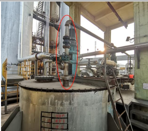
1#泡沫槽VOCs放散点
