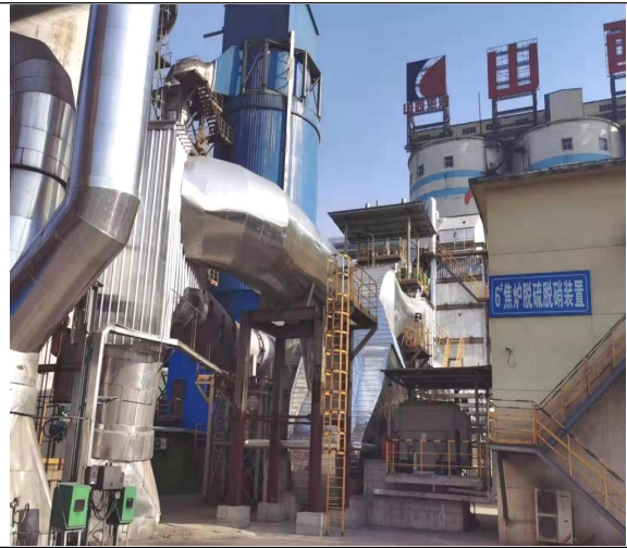
6#焦炉烟气脱硫脱硝装置
