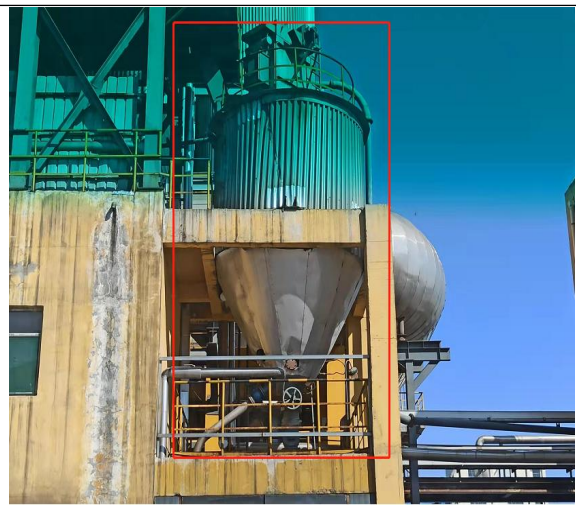
4#焦炉烟气除尘灰料仓
