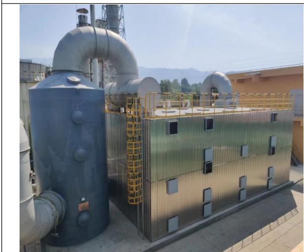
碱洗塔及生物滤床
