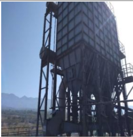
二系粉碎机除尘器
