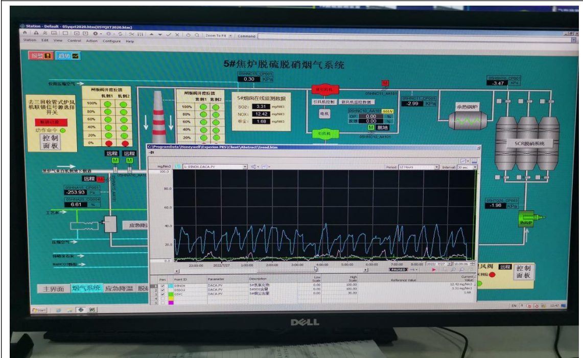
5#焦炉烟气脱硫脱硝 CEMS 数据、生产设施运行参数接入 DCS 系统截图
