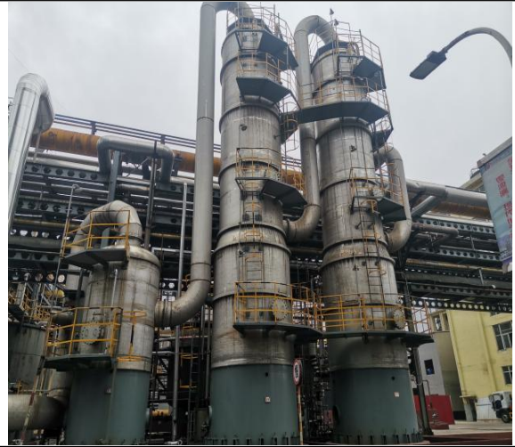
二回收放散点放散气 (VOCs) 处置设施
