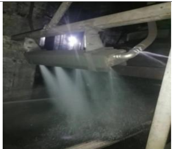
输煤皮带机尾干雾抑尘雾帘装置
