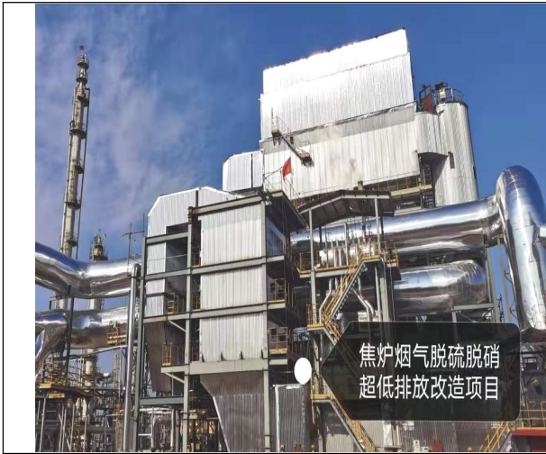
5#焦炉烟气脱硫脱硝装置
